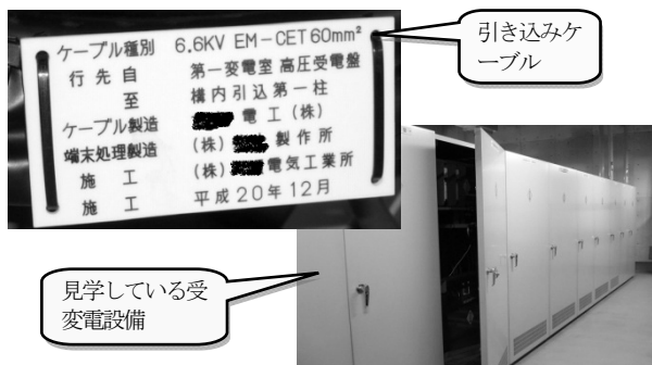
写真1 見学しているポリテク中部の受変電設備
