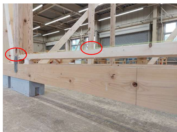
写真 11-7 窓台のたわみ状況
