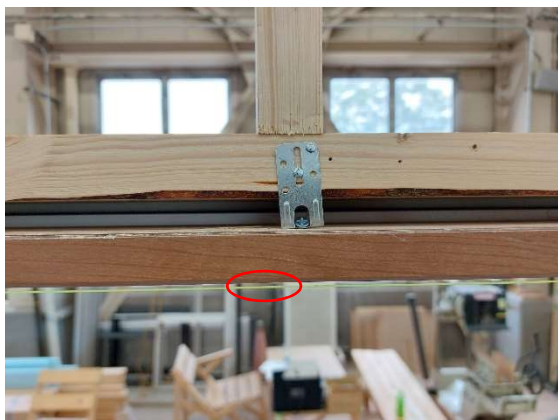
写真 14-21 窓枠のむくり状況
