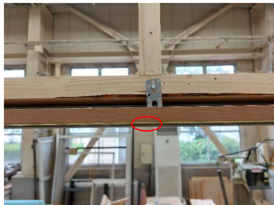
写真 14-20 窓枠のたわみ状況
