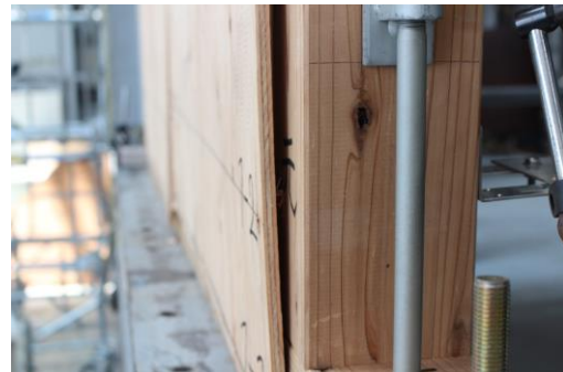
③面材の浮き(未計測)と釘のパンチング状況
