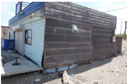
図 4.2 劣化が進んだ「海の家」
