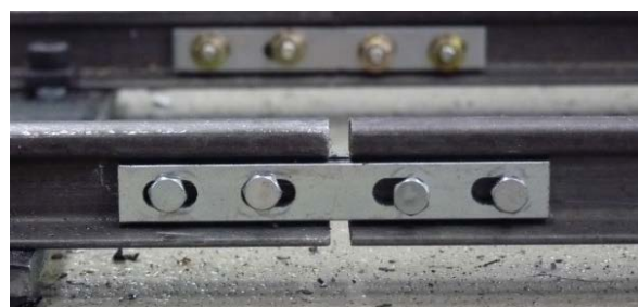
図7 連結部の隙間
