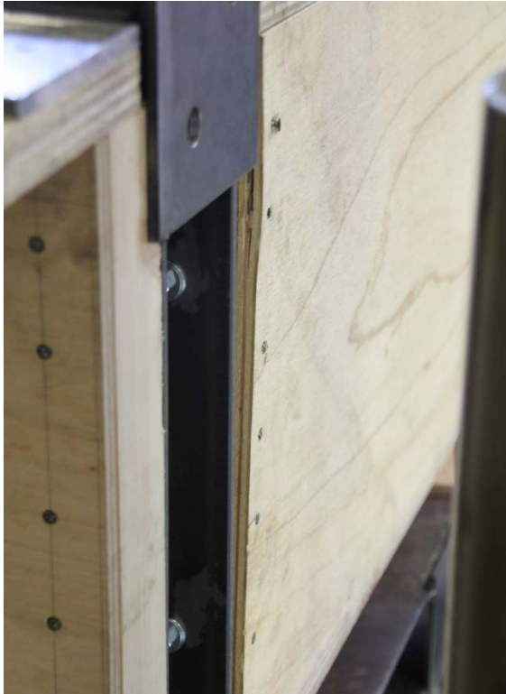
写真 6-4 破壊状況 背板引張側のくぎの抜け出し
