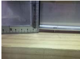
(d) 鋼製枠の浮き上がり
