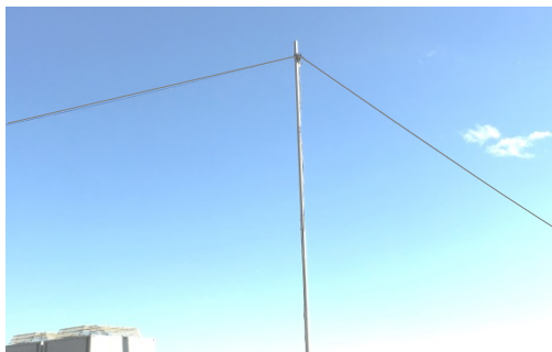
図 3 実験棟屋上に設置したアンテナ
