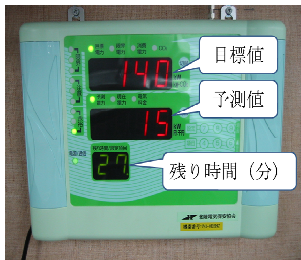
写真 11-1 デマンド監視装置
