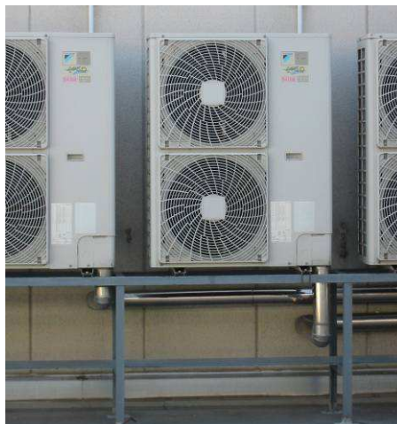
写真 5-2 室外機の設置例
