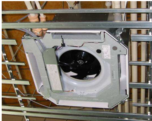
写真 5-1 室内機の設置例
