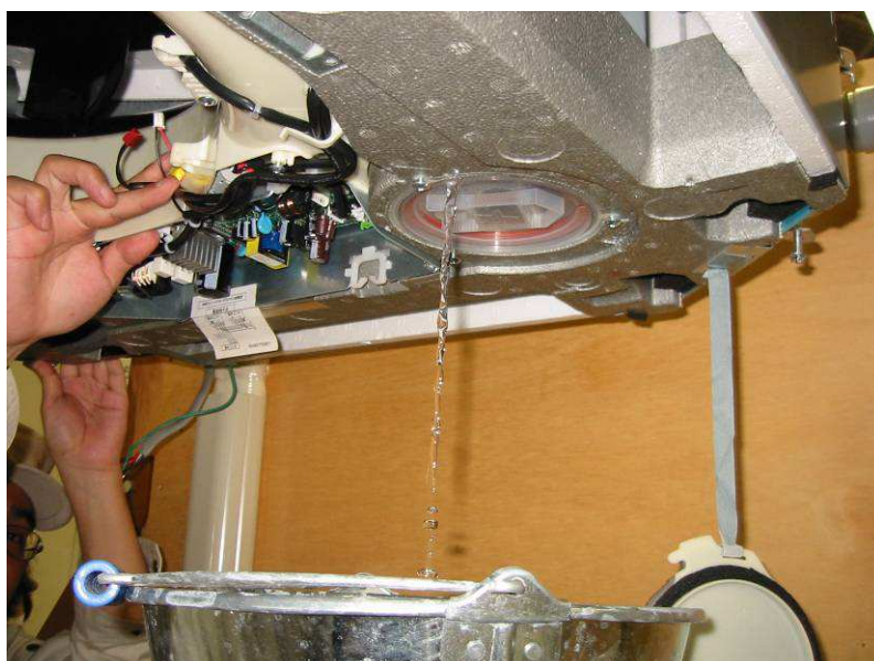
写真 13-2 ドレンパンの水抜き
