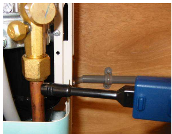
写真11-5 ガス側配管温度測定
