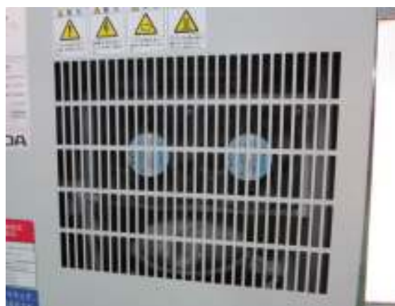
エアドライヤー外観
