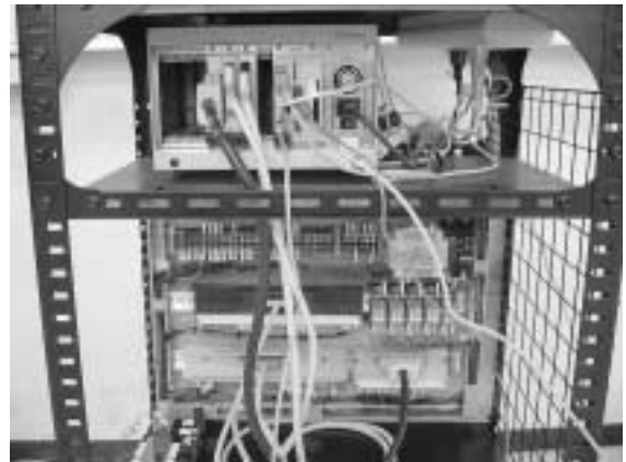
図5 試作制御盤内部（上段部分がFAコンピュータ）
