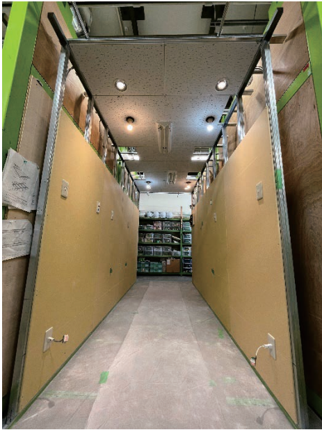
図4-3 電気工事实習場
