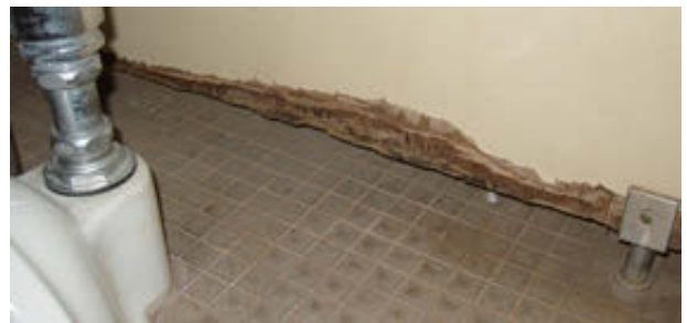
図4 ブース劣化状況
