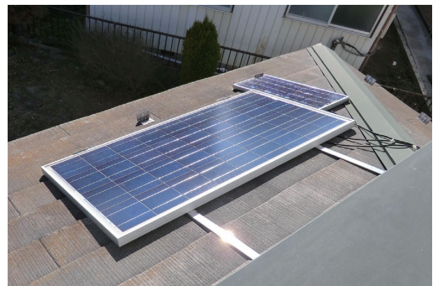
120W ソーラーパネル（一階の屋根に設置）
