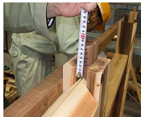
写真23 壁と梁の隙間
