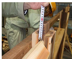
写真23 壁と梁の隙間
