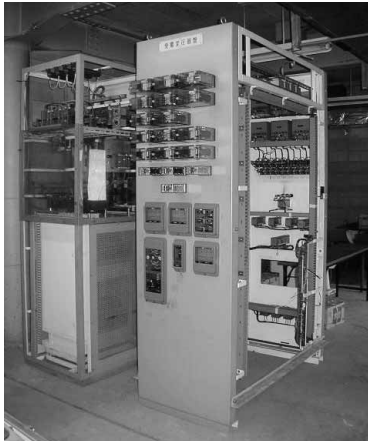
写真3 変電技能訓練設備
