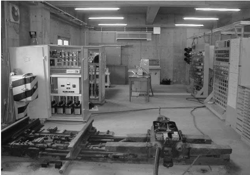
写真2 信号技能訓練設備
